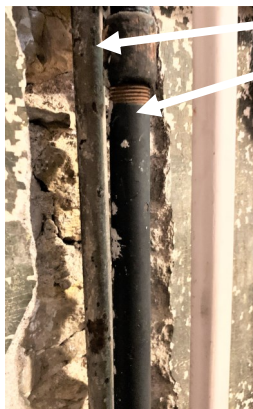
Electric conduit Gas pipe
